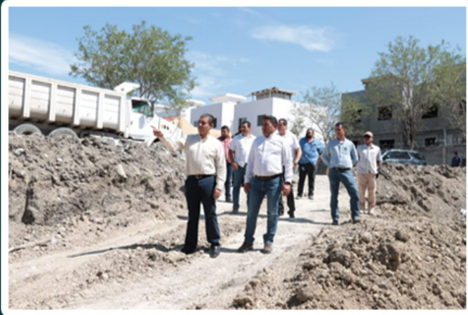
SUPERVISA PACO TREVIÑO AVANCES DE OBRA PLUVIAL DE MÁS DE TRES KILÓMETROS
